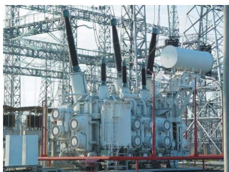
Электрические сети Электростанции, подстанции, линии электропередач
