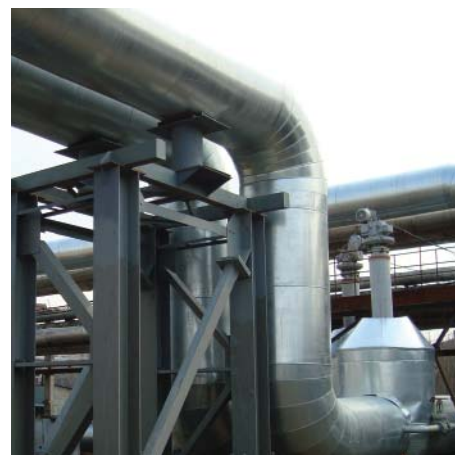
Системы вентиляции, кондиционирования и трубопроводы
