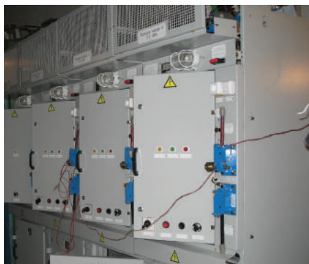
Электрические шкафы Защита внутренней разводки распределительных шкафов
